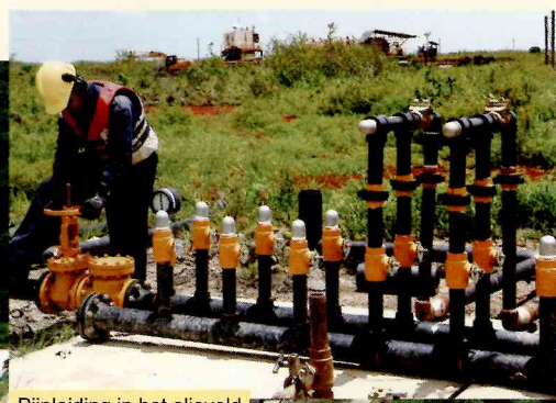
Pijpleiding in het olieveld
