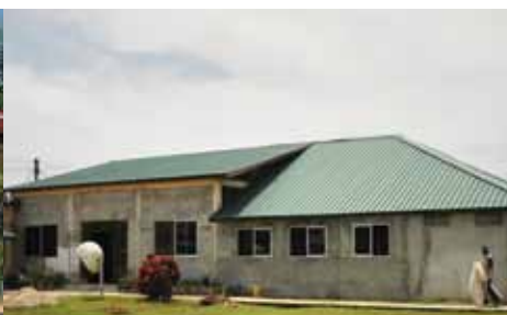
Vernieuwing van de gehele dakconstructie en dakplaten inclusief plafond van bejaardenopvang Kibri Mi. A complete new roof construction and roof covering, including the a new ceiling for the retirement home Kibri Mi.
