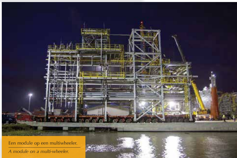
Aankomst eerste module op constructiesite te Tout Lui Faut. Arrival of the first module at the construction site at Tout Lui Faut.
