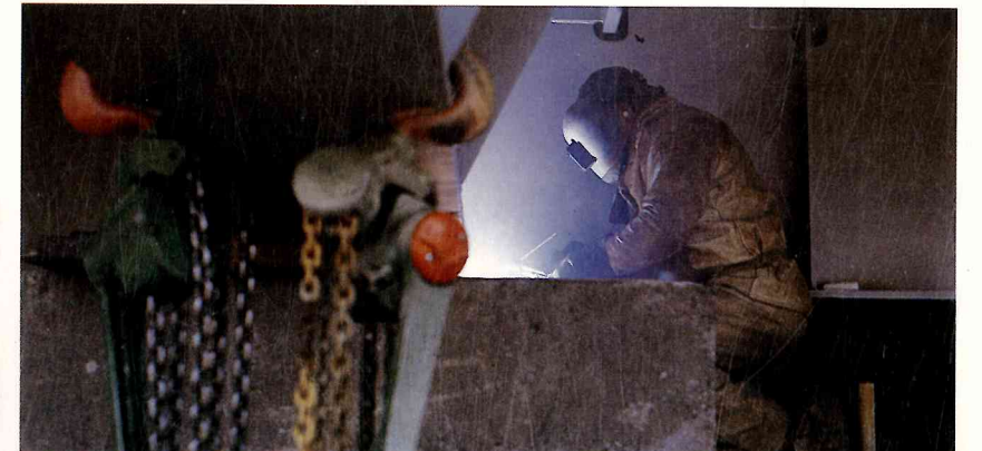
Werk bij toeleveranciers: hier constructie- en laswerk bij HCG voor het platform Ameland Westgat
