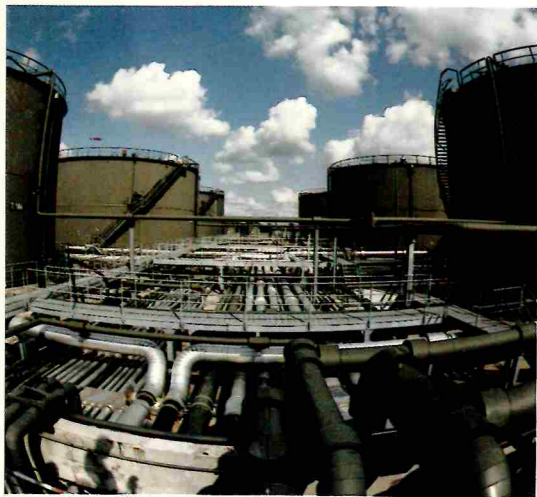
Ruwe-olieverlaadstation/ emulsieverwerkingsinstallatie in Schoonebeek.
