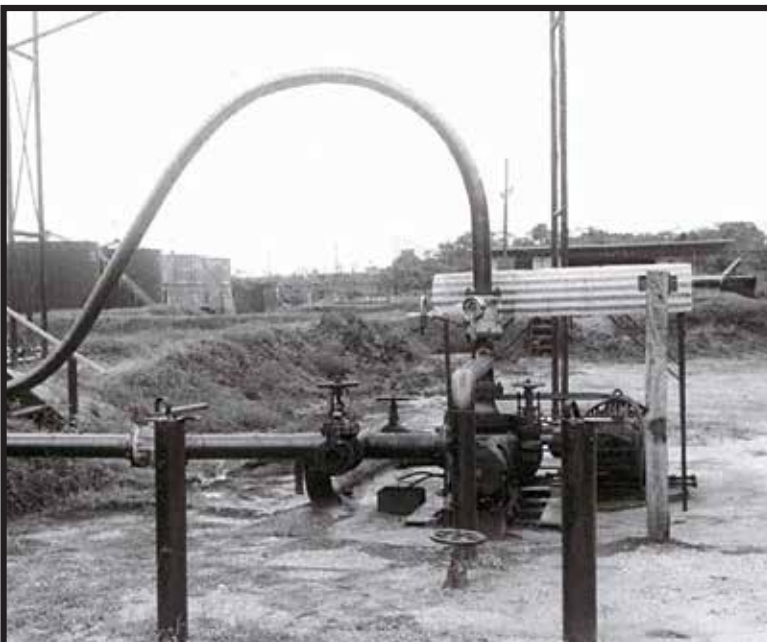
1981 Een creatieve oplossing om de Saramacca Crude beter te laten stromen. / A creative solution to facilitate the flow of Saramacca Crude.
